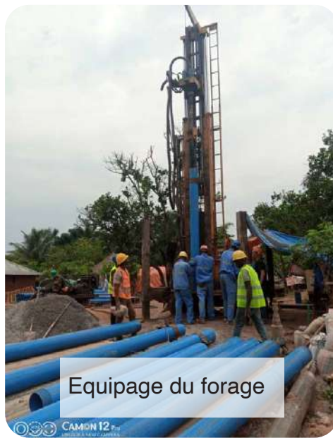
Installation pompe des essais d'une puissance de 5,5 kw avec un débit de 8 m cube par heure à une hauteur de 160 m
